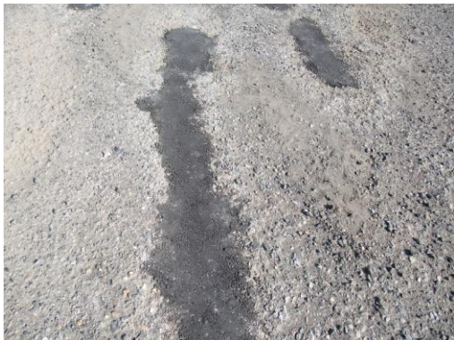
右は補修前、左が補修後、このような凹 が会場内 3,000 m 2 に無数にあります。
